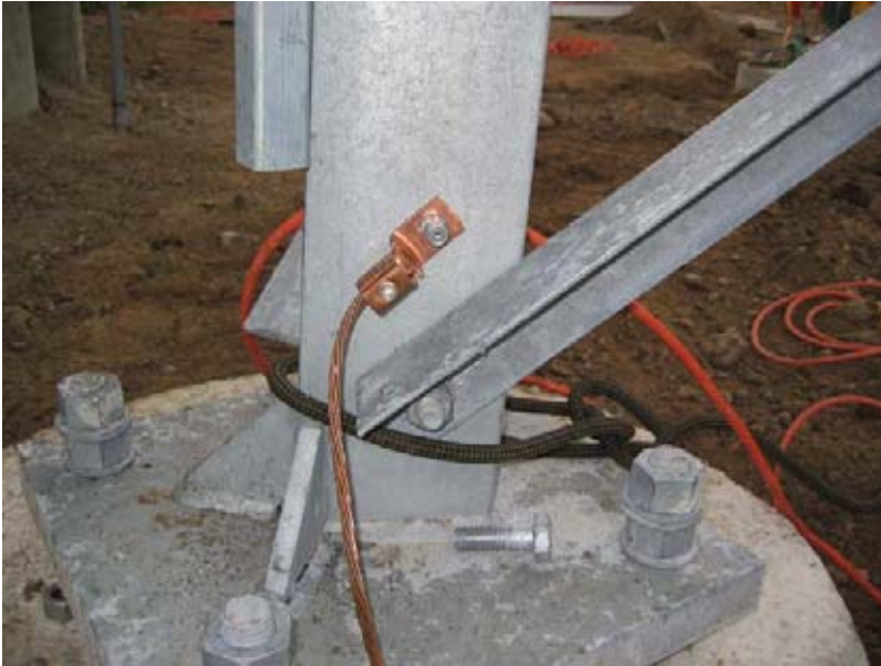
Figura 5.2: Uma torre com aterramento pesado de fios de cobre.
