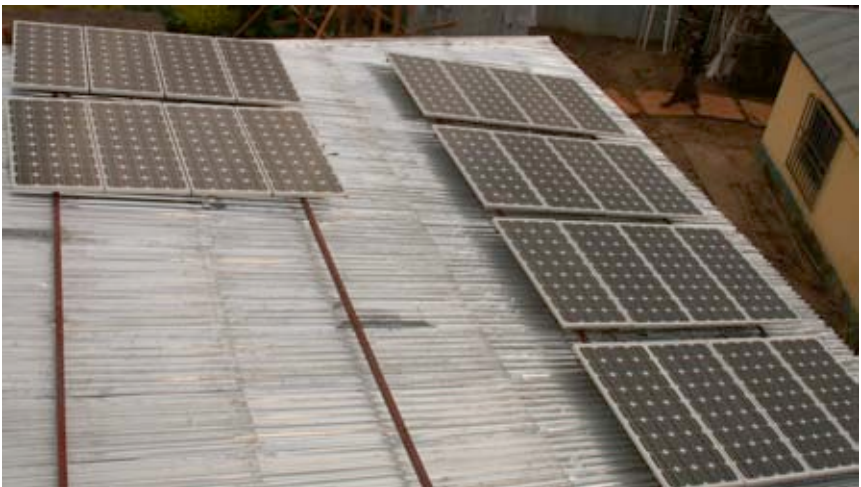
Figura 11.1: 24 painéis solares com a potência nominal de 80 W foram montados no telhado do centro de operações para garantir a alimentação ininterrupta ao sistema.
