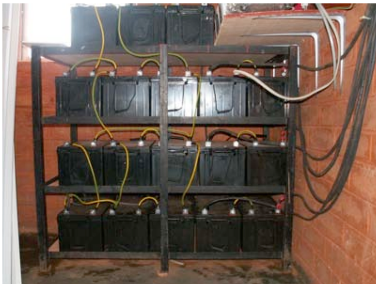
Figura 7.9: Um banco de baterias de 3600 Ah. A corrente chega a 45 A durante o carregamento.
